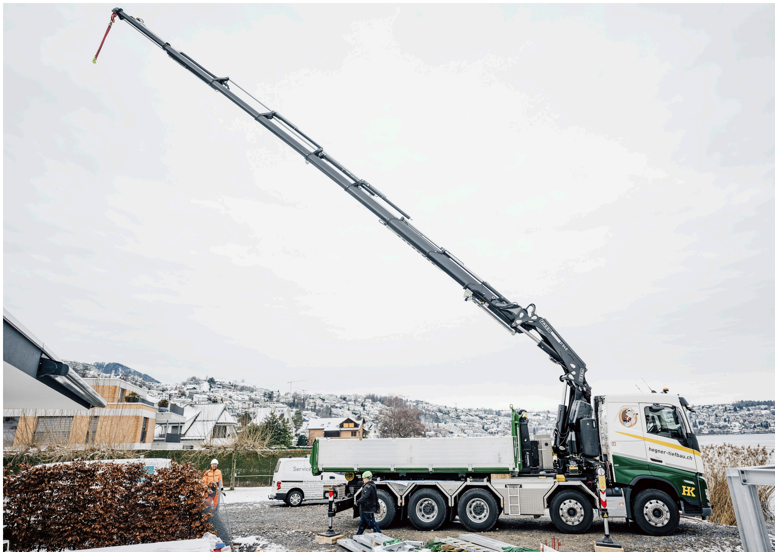
Der Fassi F545RA.2.28 hat eine maximale Ausladung von 23 m (bei 1200 kg). Die Hublast beträgt 15 t. Damit ist das Kranfahrzeug für diverse Arbeiten stark ausgerüstet.
